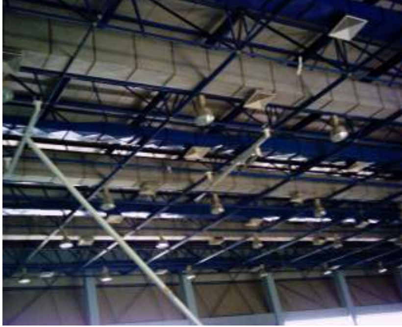
İnönü Üniversitesi Spor Salonu ( İki Kanallı Havalandırma Sistemi Örneği)
