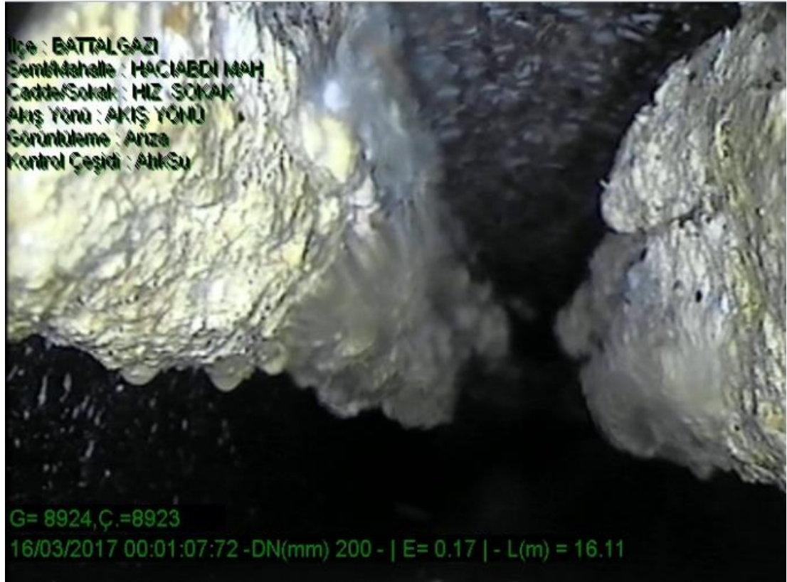
Şekil 4.5. Yapısal Kusurlar, Yağ ve Gres (MASKİ, 2018)
