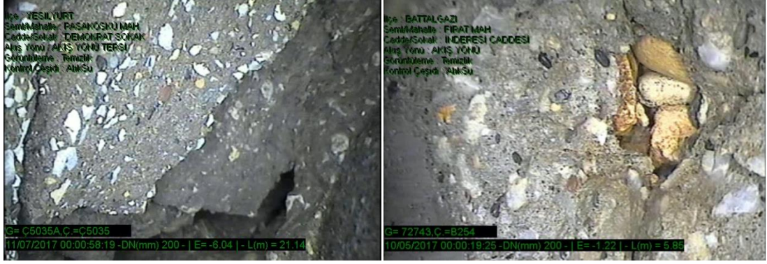
Şekil 4.8. Yapısal Kusurlar, Bozulma/Deformasyon (MASKİ, 2018)
