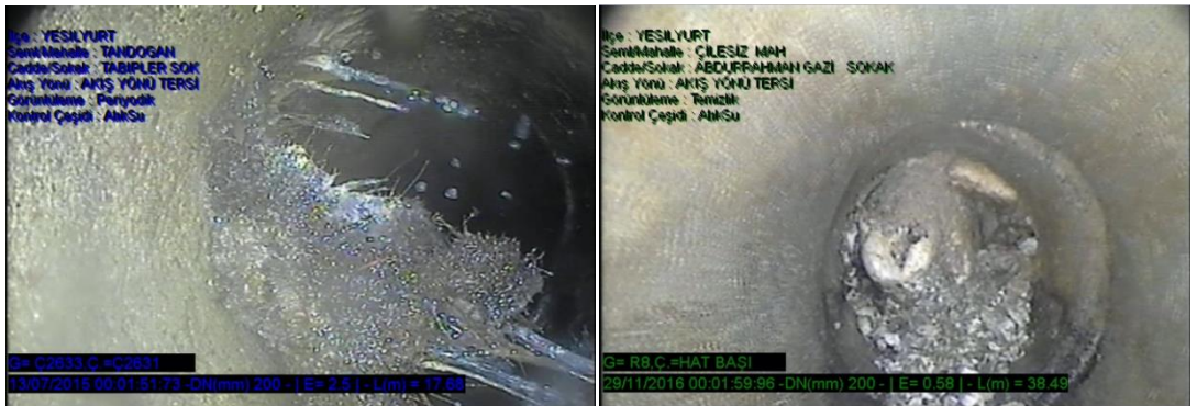
Şekil 4.12. Yapısal Kusurlar, Tıkanıklık (MASKİ, 2018)
