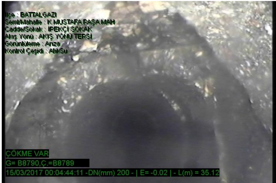
Şekil 4.7. Yapısal Kusurlar, Çökme (MASKİ, 2018)
