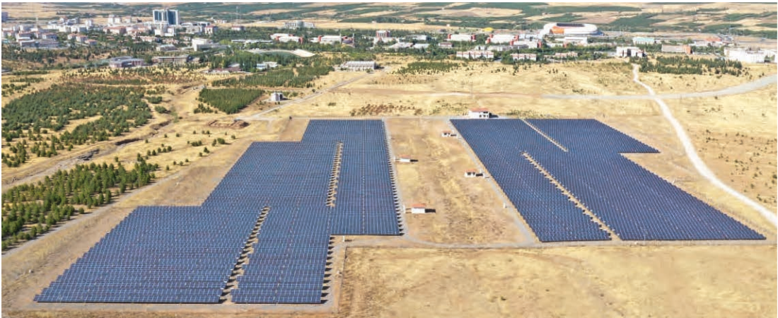
İnönü Üniversitesi Güneş Enerji Santrali
