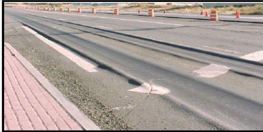
Şekil 2.29. Tekerlek izi oluşumu[19]
