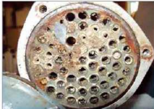
Şekil 2.16. Isı değiştiricisindeki birikintiler
