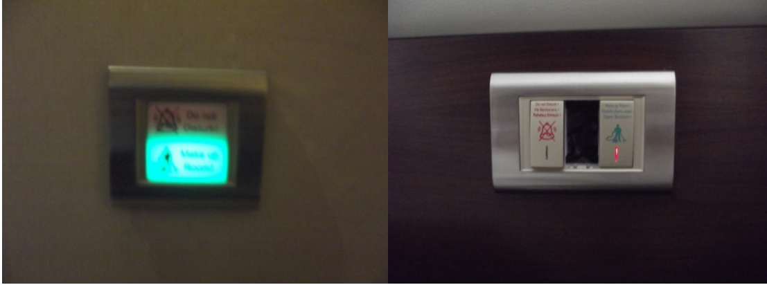
Sekil 3. "Lütfen rahatsız etmeyiniz" veya "Odanın temizlenmesi" isteğine bağlı olarak tasarlanmış yatak başı, oda kapısı bağlantılı düğme, Ramada Otel, Antalya, 2011
