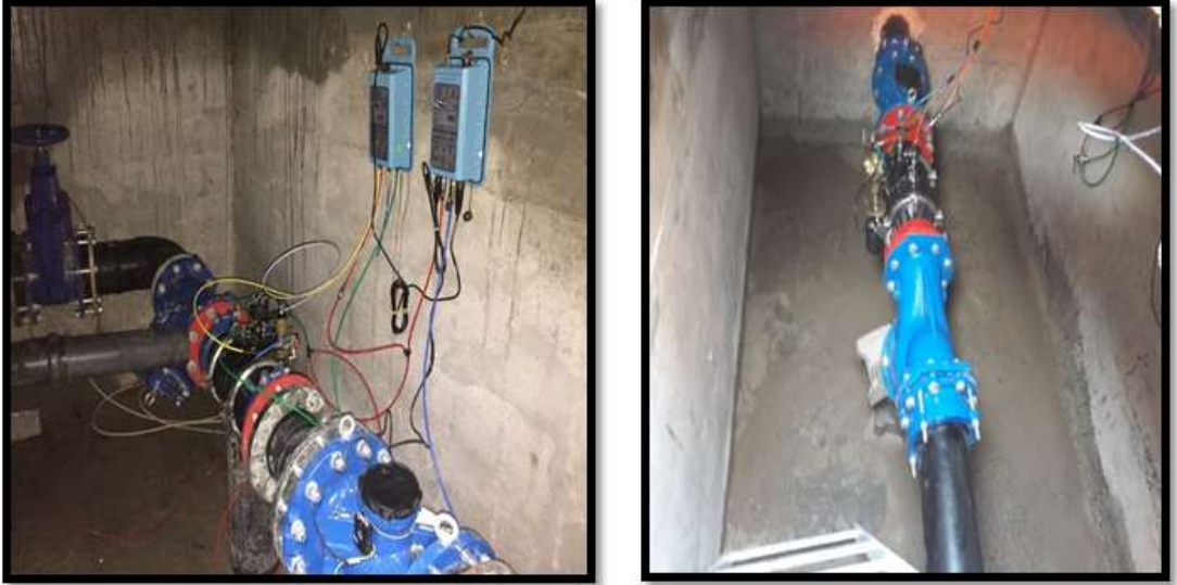
Şekil 6.1 Yerleştirilen Basınç Kırıcı Vanalar
