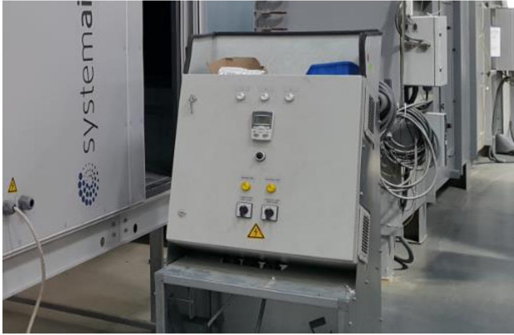
Şekil 4.5.a Fanın frekans kontrol paneli
