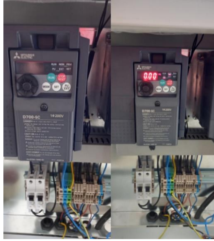
Şekil 3.9: Frekans invertörlü fan kontrol paneli
