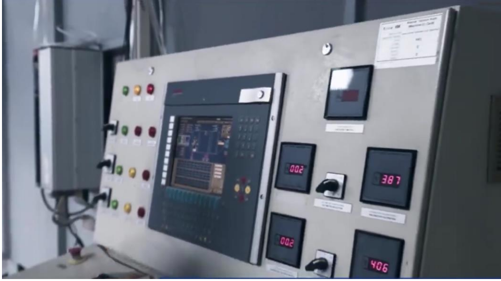
Şekil 3.7: Ölçüm kontrol paneli
