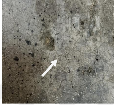
Şekil 4.28. Sülfat direnci deneyi sonrası numunelerin yüzeylerinde oluşan kılcal çatlakların görünümü.
