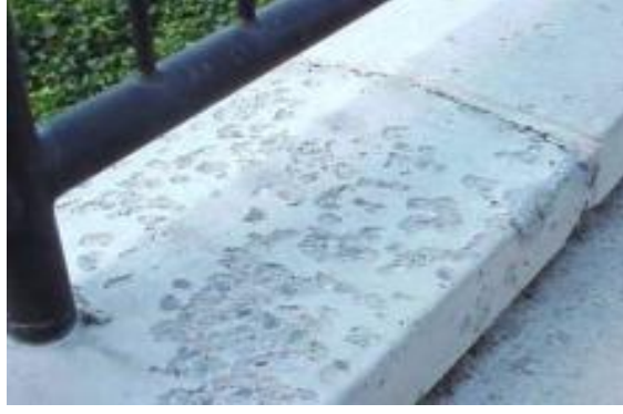
Şekil 2.27. Betonda donma çözülme etkisi.
