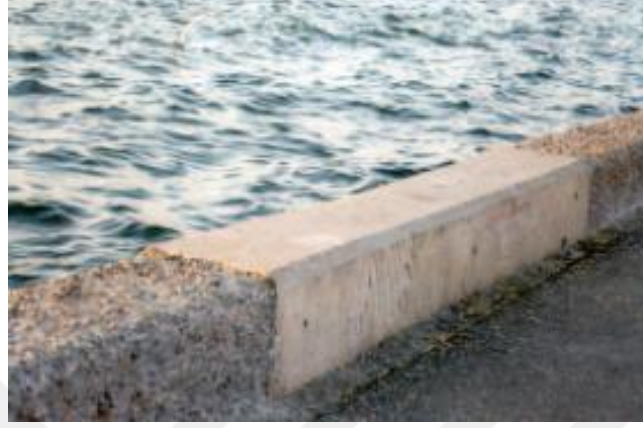
Şekil 2.28. Betonda deniz suyu etkisi
