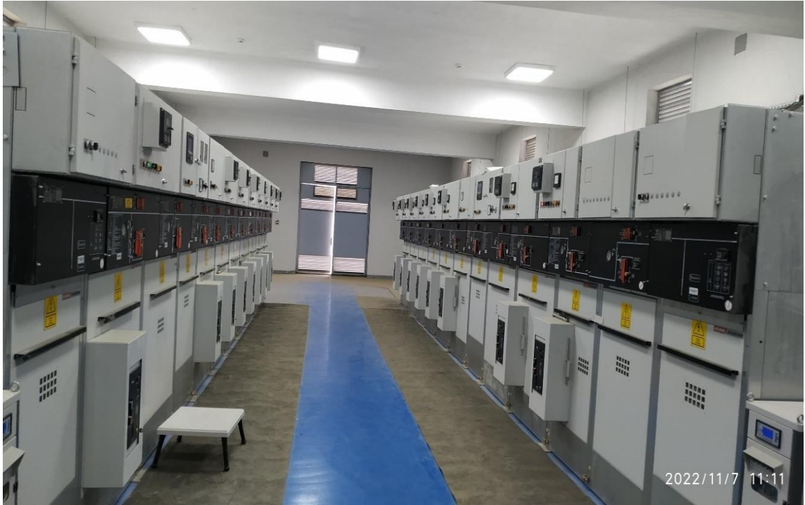
Şekil 2.1 : Enerji dağıtım merkezi.
