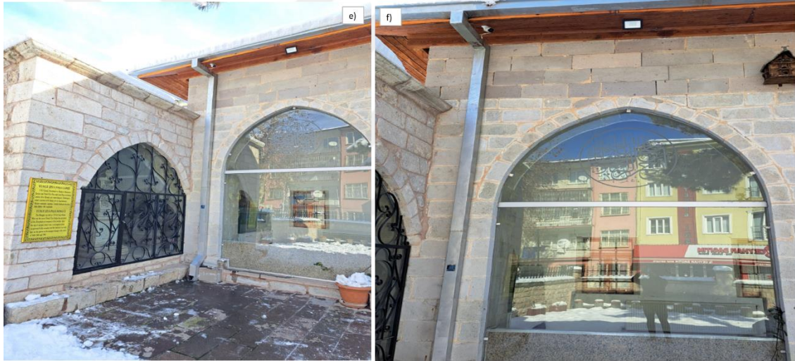
Şekil 8.12: 6 Şubat 2023 Kahramanmaraş depremleri öncesi ve sonrası yapıda oluşan çatlaklar.
