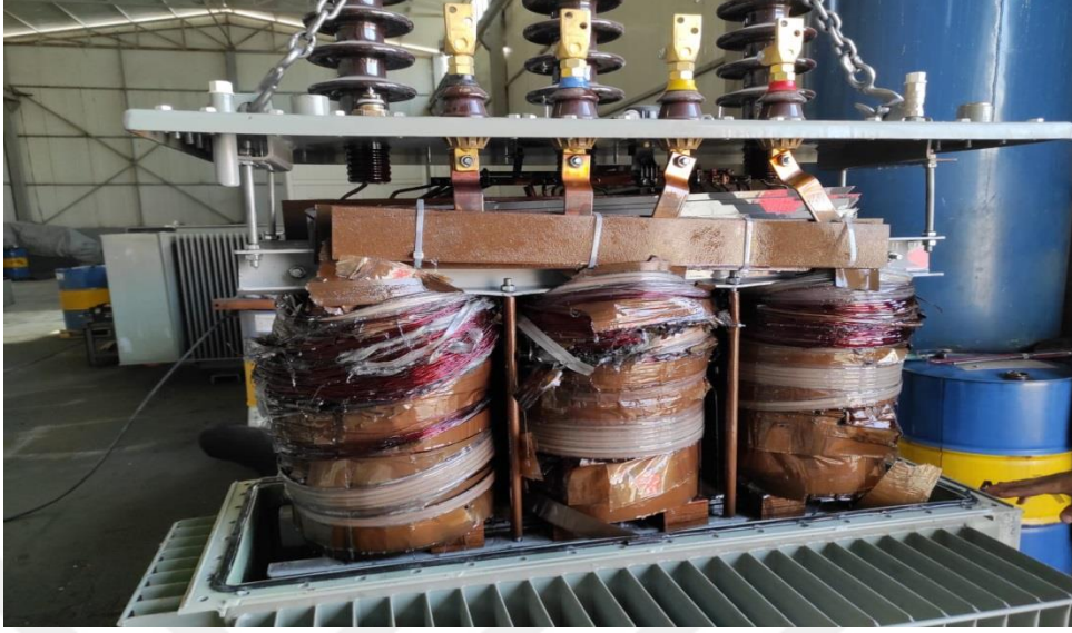
Şekil 3.3: Aşırı gerilime maruz kalmış transformatör örneği.
