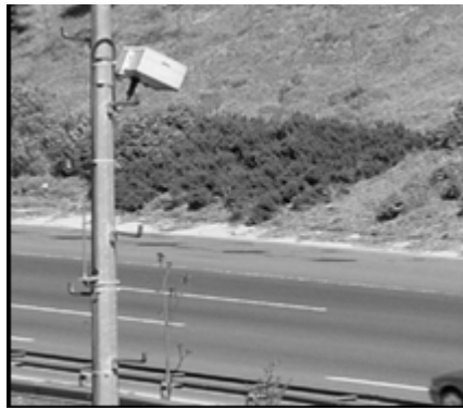
Şekil 6.5 Yol kenarına yerleştirilmiş bir RTMS
