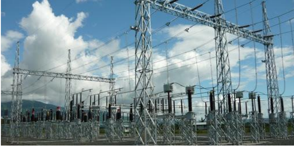
Şekil 5. 4: Şalt sahası görünümü [39].
