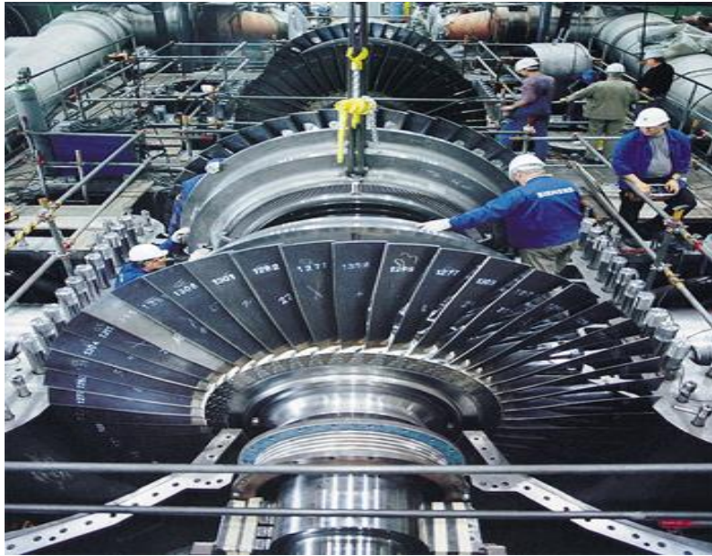
Şekil 3. 2: Termik santralde türbin [24].
