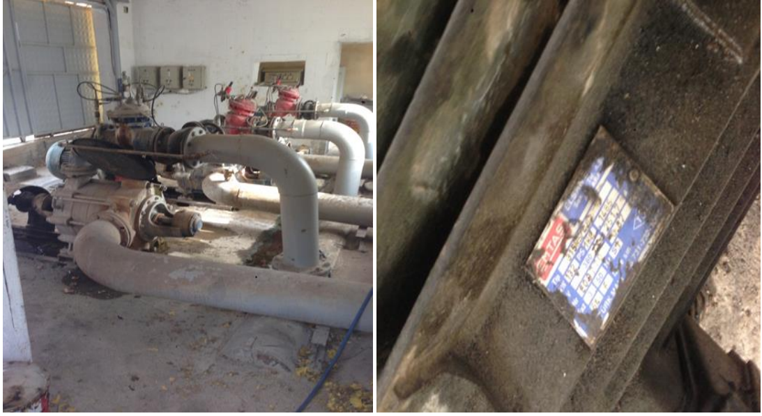
Şekil 4.3. Şehir merkezinde hizmet veren Kırkgöz terfi merkezi genel görünümü
