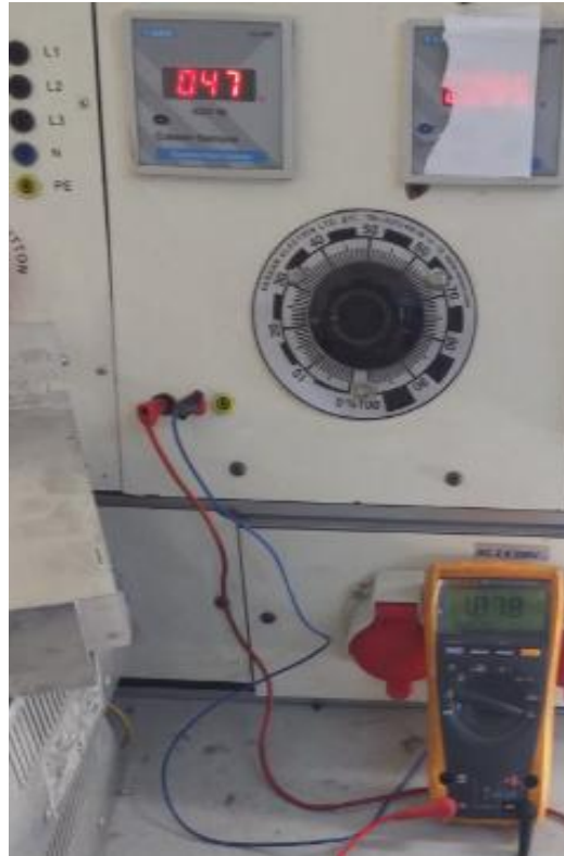
Şekil 4.12. Tam yük testinde ampermetrenin ölçtüğü yük akımının değeri ve transformatörün alçak gerilim besleme voltajı
