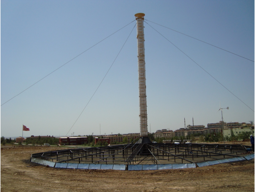
Şekil 3.20 Güneş bacası sistemi güneş kollektörünün taşıyıcı metal profil aksamı
