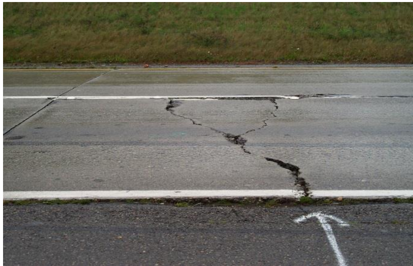
Şekil 2.42 : Termal çatlak örneği.
