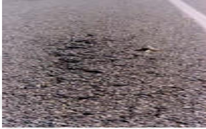
Şekil 2.43 : Kaplamada meydana gelen ayrışmalara örnek.
