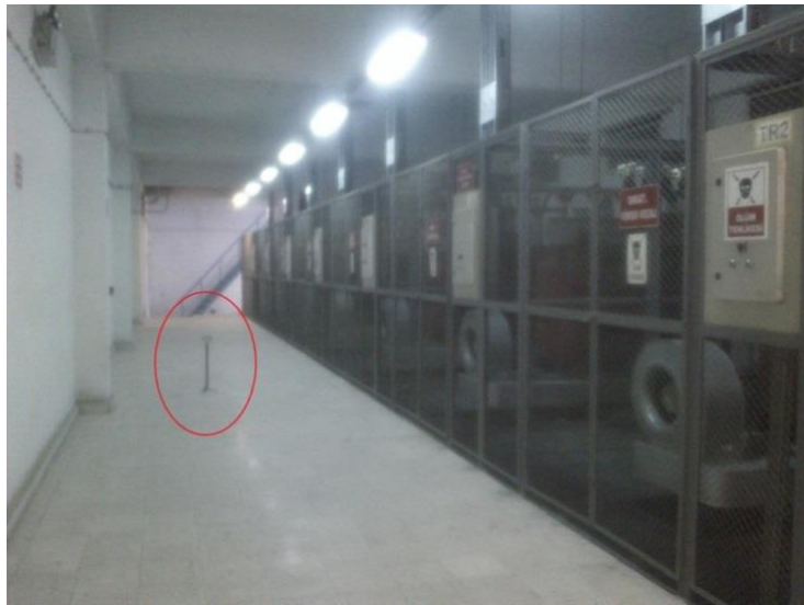
Şekil 4.41. Turgut Özal Tıp Merkezi B2 katında trafo bölgesinde düşük (güç) frekansındaki elektromanyetik alan ölçümü
