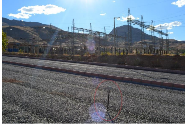
Şekil 4.38. Şalt sahası yakın bölgesinde, güç frekansında elektromanyetik alan ölçümü
