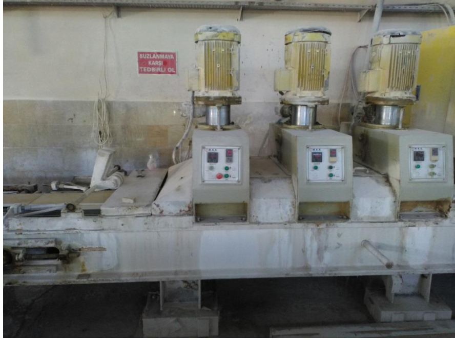
Şekil 3.8. Kalibre makinesinin tesiste görünümü
