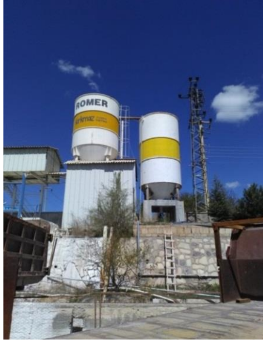
Şekil 3.16. Tesiste arıtma sisteminin görüntüsü
