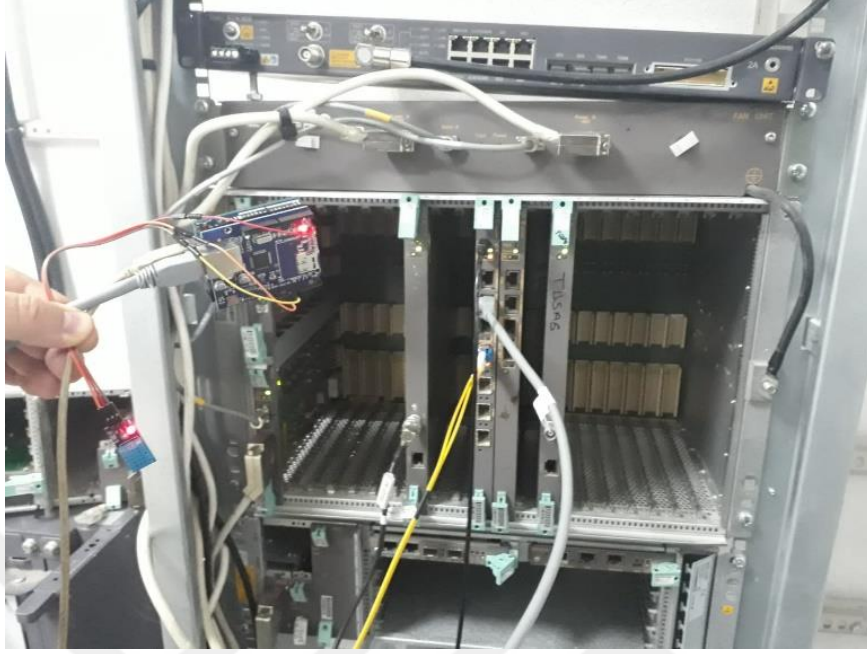
Şekil 4.13: Ericsson 20P Magazin (Switch Bağlantısı)
