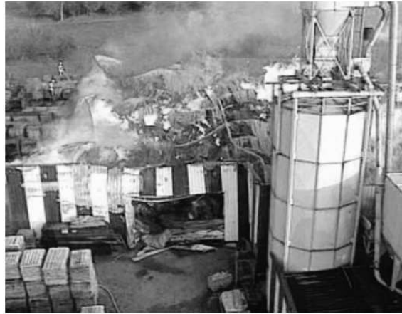
Şekil 4.6. Metal trapez çatının yangına katkısı
