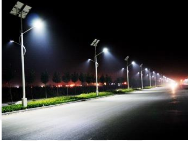
Şekil 4. 7. Güneş paneli sistemli sokak aydınlatma direkleri [48]
