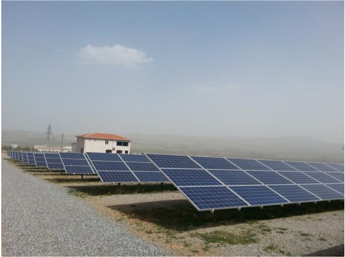
Şekil 6.2 Malatya’da Bulunan Güneş Enerjisi Santrali
