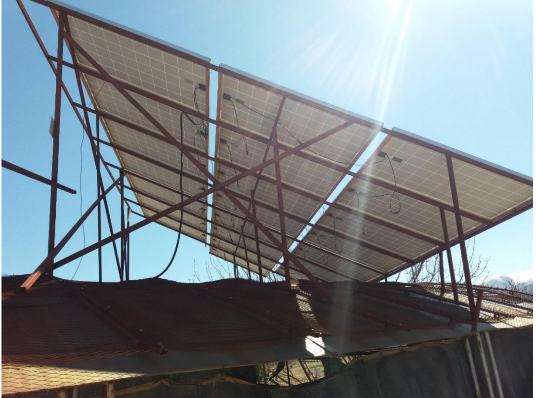
Şekil 5.4 Tesisteki panellerin karkas yapısı ve kablolar
