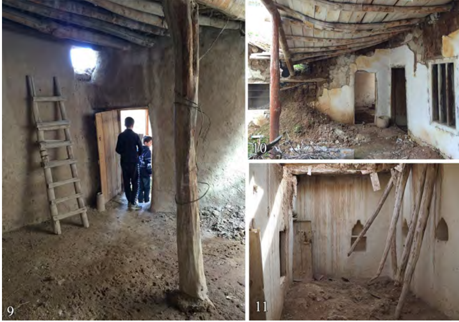
Fig 9- Bakımsız kalmış damdan toprak tabana yağmur akması, Balaban, 2016
